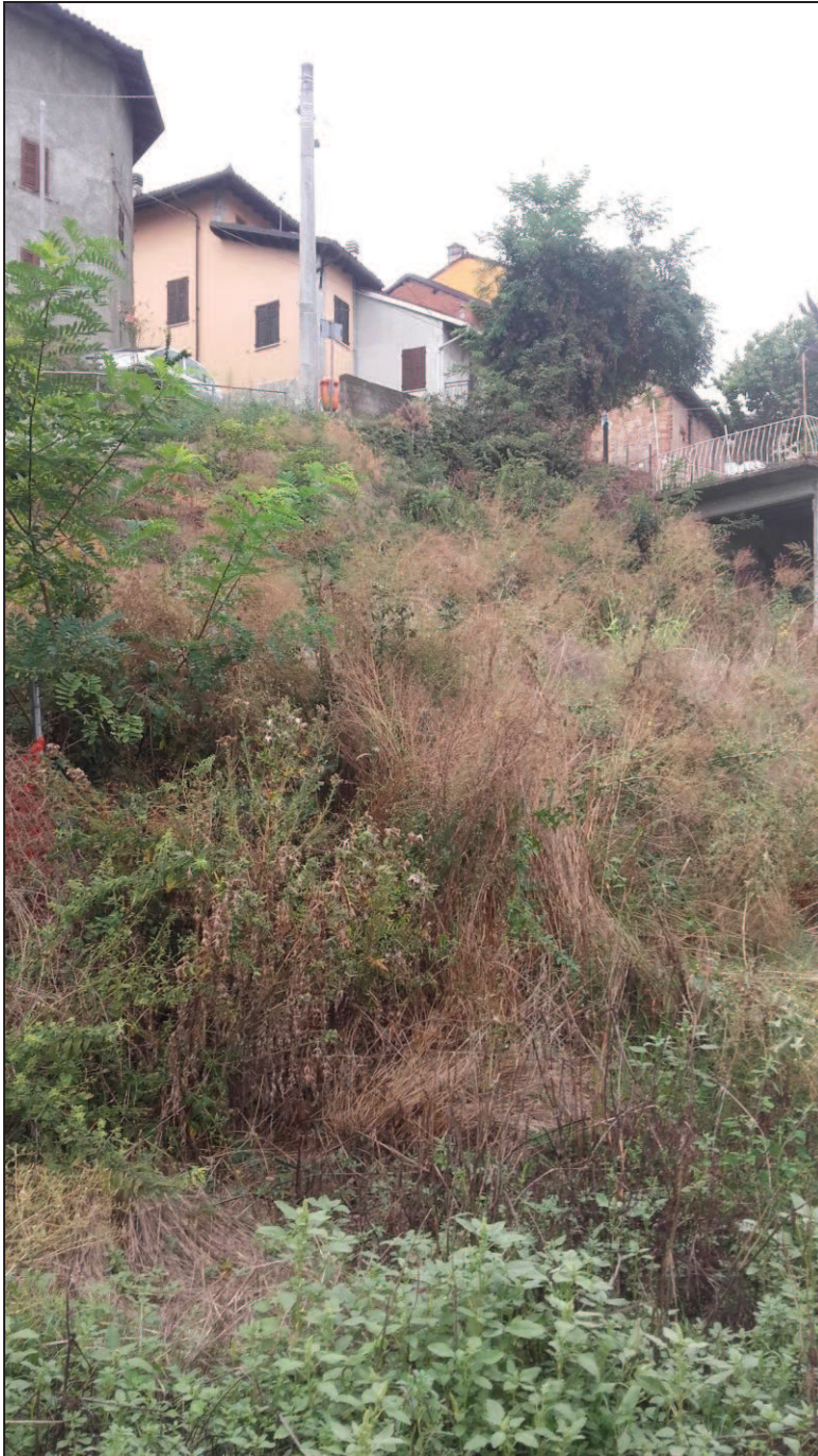
Scarpata al raccordo terreni alluvionali di fondovalle sponda destra del rio Bicogno, alla sommità erosione coltre superficiale.
